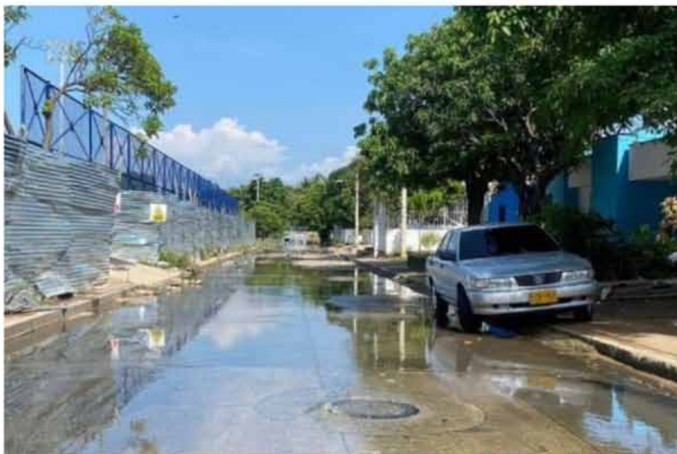
cColapso del sistema de alcantarillado
