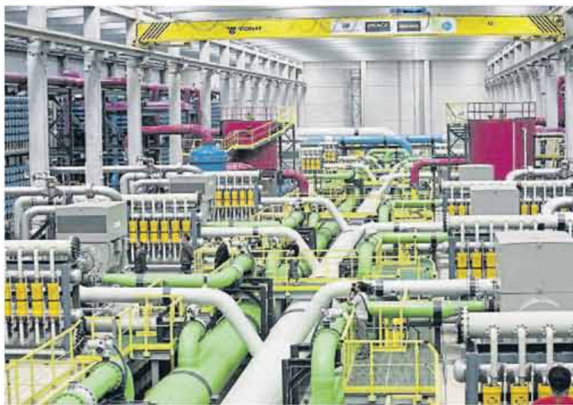
La desalinizadora de El Prat de Llobregat, gestionada por la empresa pública ATL.
