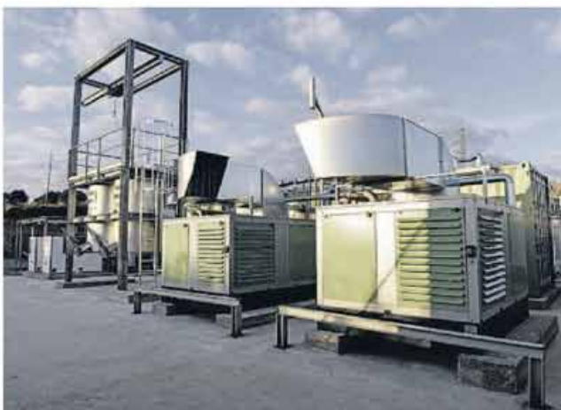
La planta Elena, en Cerdanyola del Vallès, dedicada a la producción de biometano a partir de los residuos sólidos urbanos
